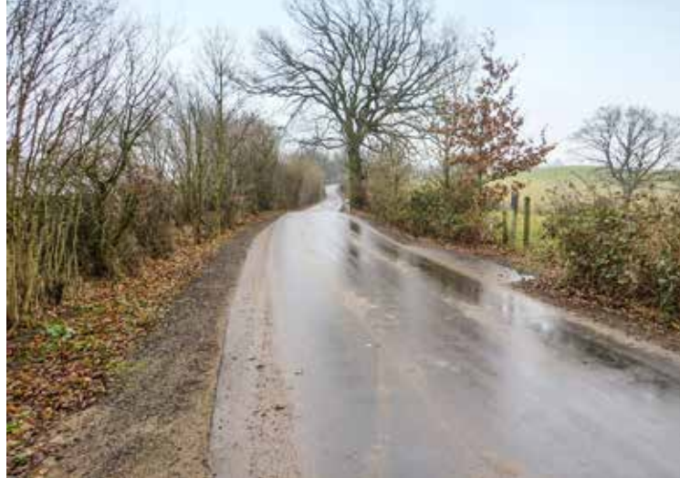
Verstärkung des Ortsverbindungsweges von Gömnitz nach Vinzier in der Gemeinde Süsel. Fotos: Ilur
